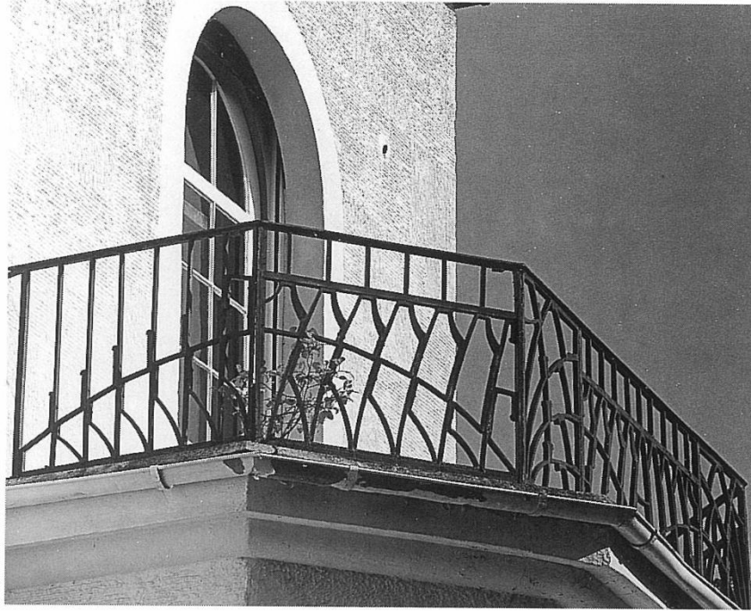
206 Villa Berlepsch, Karlstrasse 29, München-Planegg: Schmiedeeisernes Balkongitter an der Südseite im 1. Stock. Aufnahme von 1990. Vgl. Kat. Nr. 12.9 a.
