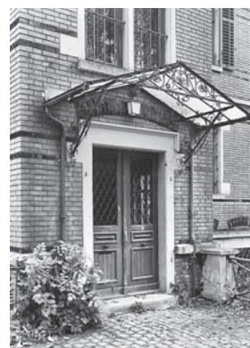
Treppenhaus-Eingang mit Vordach an der Südfassade. Zustand vor der Restaurierung, September 2000. Fotoarchiv HBA.
