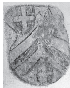
Mit Rötöl gezeichnetes Wappen an der Südwestwand des ehemaligen Beinhauses. Zustand Februar 2003. Fotoarchiv HBA.
