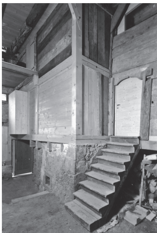
Schopfraum 0.04. Teilansichten der Bohlen- ständerkonstruktion der Trennwand gegen den Wohnteil. Links: Ruinöser Zustand Oktober 1987. Rechts: Zustand nach der Instandstellung mit neu erstellter Blockstufen- treppe, März 2001. Vgl. Querschnitt mit Schadens- kartierung S. 177. Foto- archiv HBA.
