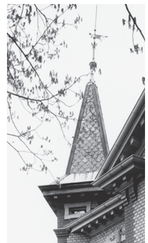
Teilansicht des nordwestlichen Erkerturms mit Schiefereindeckung, Gratblechen und Helmzierat vor der Renovation. Zustand 1999. Fotoarchiv HBA.
