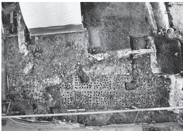
Abb. 14. Kloten. Pfarreizentrum. Phase B. Feld 17; 20; 23. Aufsicht auf die Fundamentpfählung unter der Befestigungsmauer Süd. Blick nach Norden.
