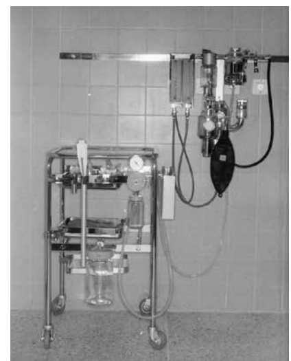
Technische Einrichtungen Operationssaal und Intensivpflegestation 1972
