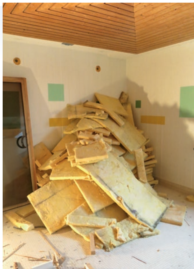
Die Isolation der finnischen Sauna muss ersetzt werden.
