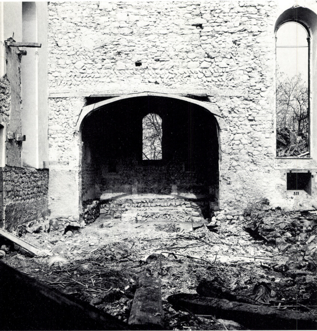
Ein interessanter Vergleich. – Rechts: Die Lazariterkirche Gfenn während der Restaurierung. Oben: Die Kirche im Wil während des Abbruchs im März 1969: Die Analogie zum Gfenn ist überraschend: Bruchsteinmauerwerk zum Teil frühmittelalterlich, quadratischer Chor mit romanischem Kreuzgewölbe und ebensolchen Fenstern und Altarnischen, Chor und Schiff von ähnlicher Grösse.
