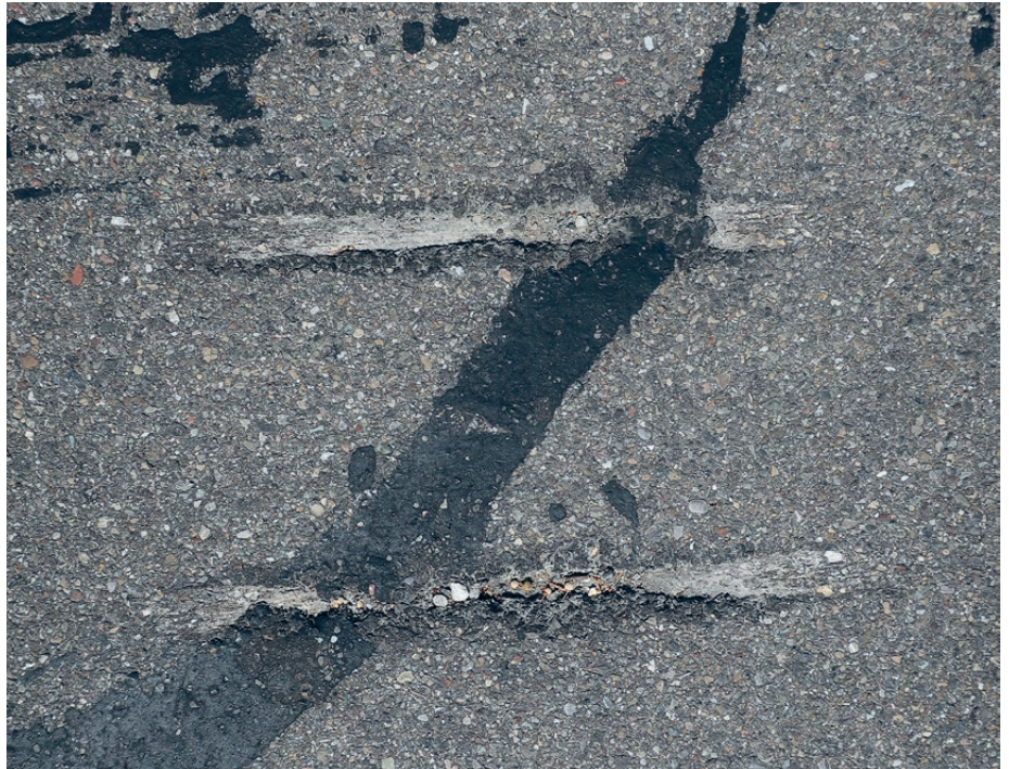
Die vom Aufprall der Postautos entstandenen Risse sind deutlich zu sehen
