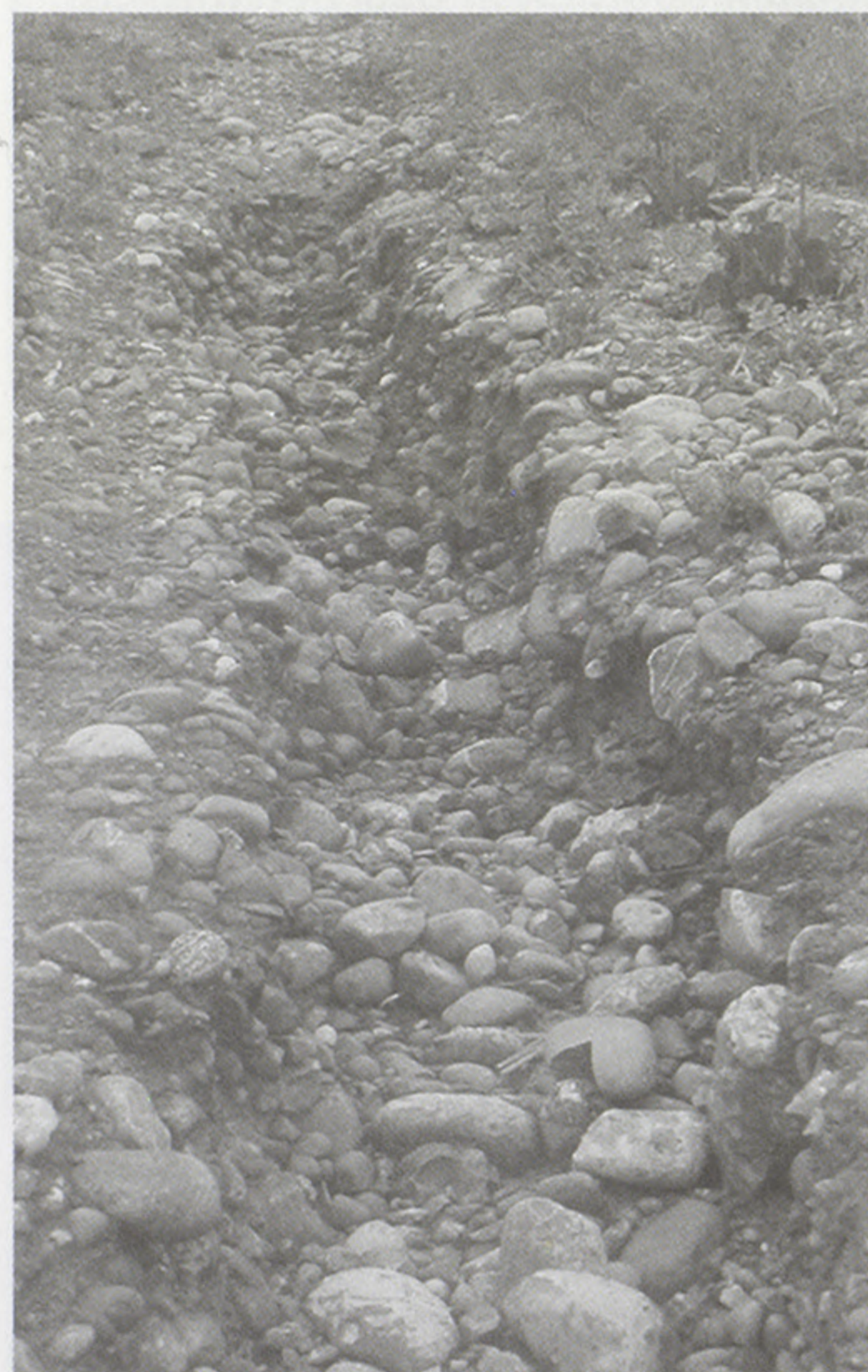
Schwemmschäden auf Spazierwegen in Wald und Feld zeugen von den niedergegangenen Wassermengen. (Foto: gw)
