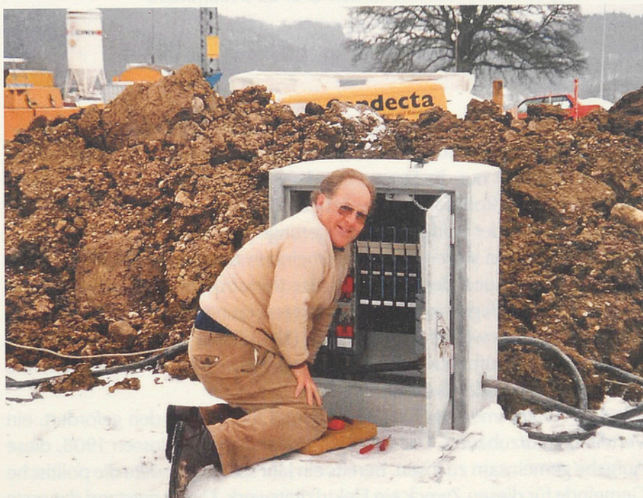
Der Gemeindeelektriker sorgt für Strom im neuen Quartier Eichweid
