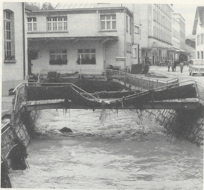
Hochwasserschaden im Maggi-Areal
