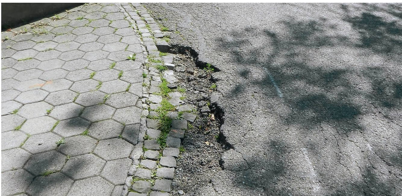
Befundaufnahme einer beschädigten Privatstrasse
