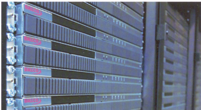
Ein System-Schrank beinhaltet 32 Nodes. In einem Computerraum der ETH Zürich stehen 48 solcher Kästen. (Bilder: Dalco AG)
