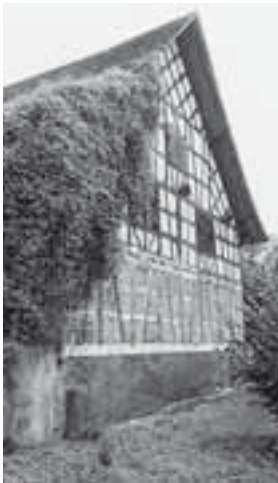
Nordöstliche Giebelfassade mit Bewuchs. Zustand vor der Instandstellung, August 2005. KDP Fotoarchiv.
