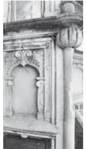
Gebäudedetail Nr. 69. Süd- fassade, Erker am 4. Ober- geschoss mit deutlichen Verwitterungsspuren am Sandstein. Zustand vor der Renovation, Mai 2007. KDP Fotoarchiv.
