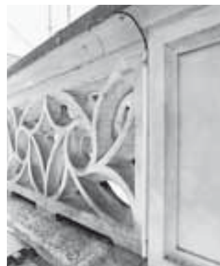
Schadenaufnahmen am Mittelteil und an den Türmen. Links: Beschädigtes Ovalfenster am Blendgiebel. Mitte: Ausschnitt des Kunststeinmasswerks bei der westlichen Schallöffnung des Nordturms. Rechts: Ausschnitt der Masswerkbrüstung an der Ostfassade des Südturms. Zustand vor der Restaurierung, Mai 2008. KDP Fotoarchiv.
