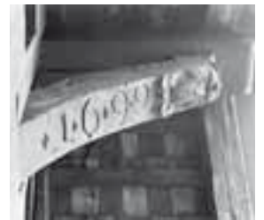
Bug der Firstpfette an der Südostfassade mit Fratze und Jahreszahl 1692. Zustand März 2001. KDP Fotoarchiv.
