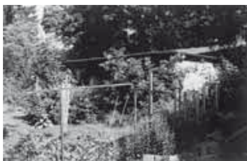
Ansichten von Südosten nach dem Einsturz des Daches bzw. des gesamten Speicheraufbaus. Zustand August 2006 und nach Abtragung des Oberbaus und der Eindeckung des Kellers mit einem Blechdach. Zustand Juli 2008. KDP Fotoarchiv.
