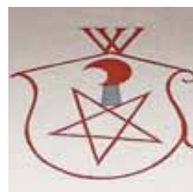
Wieser-Wappen an der Südostfassade, das 2004 anlässlich der Aussenrestaurierung nach Befund neu aufgemalt worden ist. Zustand Juni 2011. KDP Fotoarchiv.
