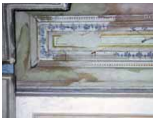
Nördliche Erdgeschoss-Loggia an der Ostfassade. Kassettierter Deckenausschnitt. Links: Zustand vor Beginn der Restaurierungsarbeiten 2006 mit erheblichen Wasserschäden. Rechts: Zustand nach der weitgehenden Rekonstruktion der Farbfassung 2006. Dok. 23.
