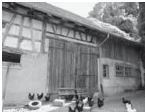
Links: Teilansicht der Nordwestfassade mit Tenntor. Rechts: Schadensbild im Bereich der südlichen Gebäudeecke. Zustand vor der Instandstellung, Juli 2007. KDP Fotoarchiv.
