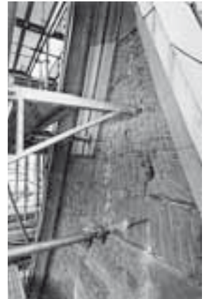
Westfassade des Nordturms im Bereich des Wimpergs. Zustand nach dem Wegschlagen von losen Steinschalen im Sommer 2003, Februar 2004. KDP Fotoarchiv.
