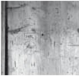
Ritzungen auf dem barocken Wandtäfer an der Nordwestwand der Stube 0.2.2. Zustand nach der Freilegung, September 2006. KDP Fotoarchiv.
