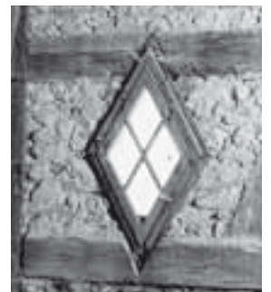
Rautenförmiges Fenster im Obergeschoss der ehem. Mühle. Zustand Juni 1991. KDP Fotoarchiv.
