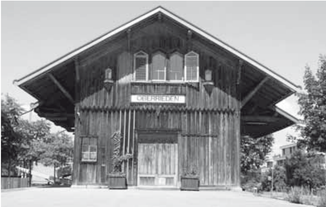
Links: Südostfassade. Zustand nach der Instandstellung, Juli 2008. Unten: Ausschnitt der Nordostfassade mit stark abgewittertem Sandsteinsockel sowie Holzverschalung am Oberbau. Zustand April 2004. KDP Fotoarchiv.
