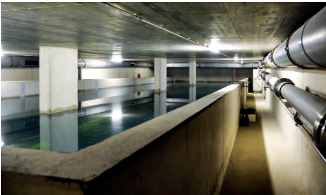
Das Regenbecken als Abwasser-Zwischenspeicher bei starkem Regen
