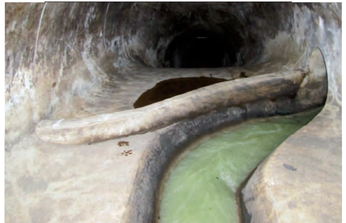
Beispiel eines Entlastungskanals hier am Bahnhofplatz
