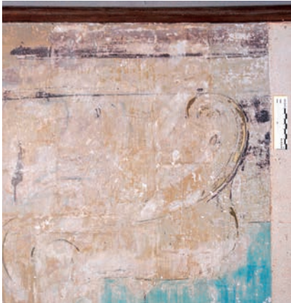
Die Probesondierungen im 2. Obergeschoss zeigten den desolaten Erhaltungszustand der originalen Malerei. Die ursprünglich reiche Wandgestaltung war bis auf wenige Reste zerstört. Es war aber trotzdem erkennbar, dass es sich um eine Architekturmalerei mit einem Ausblick ins Freie gehandelt haben musste. Aufnahme Januar 2013. Ars Artis AG.
