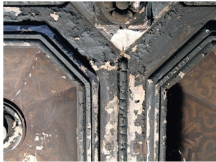
Links: Brandgeschädigte Kassette mit Blick in aufgebrochene, verkohlte Malschichtblase und Anreicherung von Öl am Übergang zum Gips. Ungefähr 50-fache Vergrösserung. Zustand Februar 2011. Foto Andreas Küng. Rechts: Deckenbereich mit verkohlten Holzstäben, stark verschwärzter bis verkohlter Malschicht und stellenweise entblösstem Gipsträger. Zustand Februar 2011. Foto Lara Quadri.
