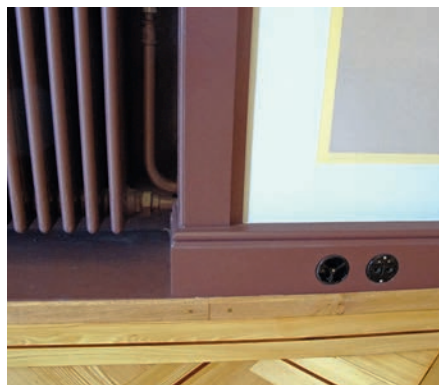
Links und rechts: Steckdosen in den als Büros genutzten Räumen im 2. Obergeschoss. Aufnahmen Mai 2013. Pfister Schiess Tropeano Architekten.
