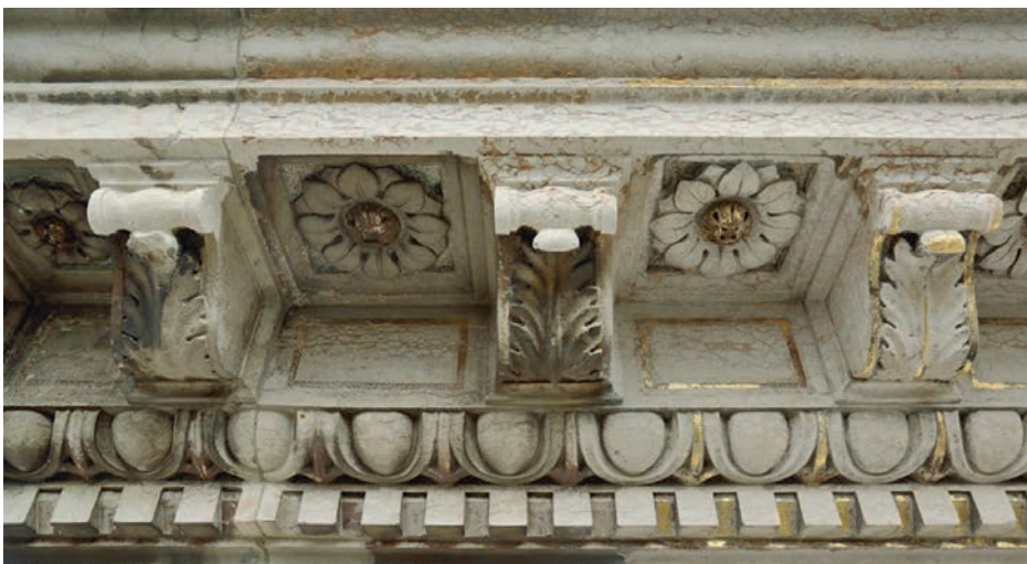
Oben: Oberflächenbearbeitung des Steins an einer Dachuntersicht. Aufnahme März 2013. Mitte: Gravur des Steinmetzen H. Hensel und Jahrzahl 1885 an der westlichen Dachuntersicht. Aufnahme April 2013. Links: Belegfeld des Vorzustands an der Nordfassade. Aufnahme April 2013. ARGE Konservierung/Restaurierung Fassaden Villa Patumbah 2013 (wie Anm. 28), S. 144, 146 und 153.
