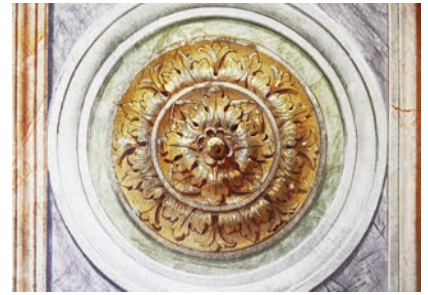
Rosette an der Nordostfassade. Zustand November 2012. ARGE Konservierung/Restaurierung Fassaden Villa Patumbah 2013, S. 85.
