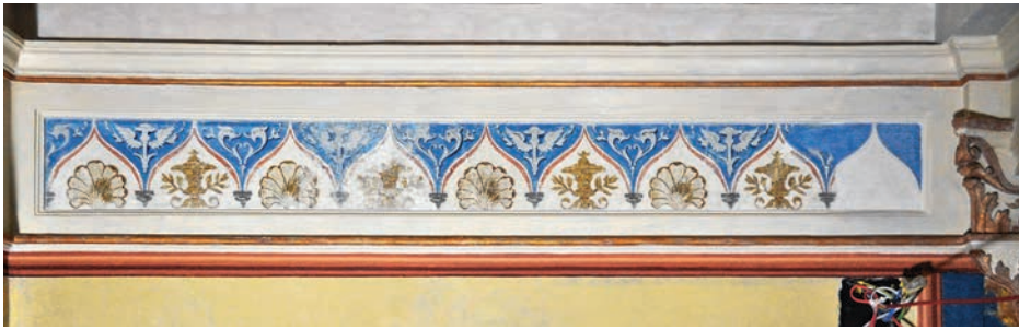
Eine flächige Ergänzung im ornamentalen Fries unterhalb des Deckengesimses. Die Grundformen werden ergänzt, nicht aber die feinen, figürlichen Malereien. Zustand August 2012. Aufnahme ARGE F3M.
