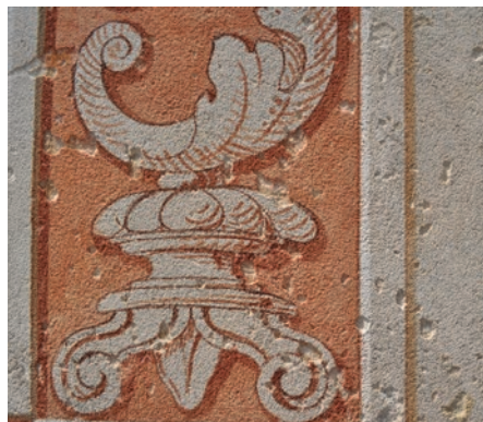
Links: Nordfassade. Fortgeschrittene Lochbildung im Malschichtmörtel durch den Witterungseinfluss. Die Absandung dehnt sich nach hinten aus. Aufnahme Mai 2011. Rechts: Nordfassade. Lochschaden im Malschichtmörtel. Aufnahme Juli 2011. ARGE Konservierung/Restaurierung Fassaden Villa Patumbah 2013 (wie Anm. 28), S. 70.
