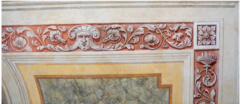
Fries an der Ostfassade. Zustand September 2012. ARGE Konservierung/ Restauration Fassaden Villa Patumbah 2013 (wie Anm. 28), S. 26.
