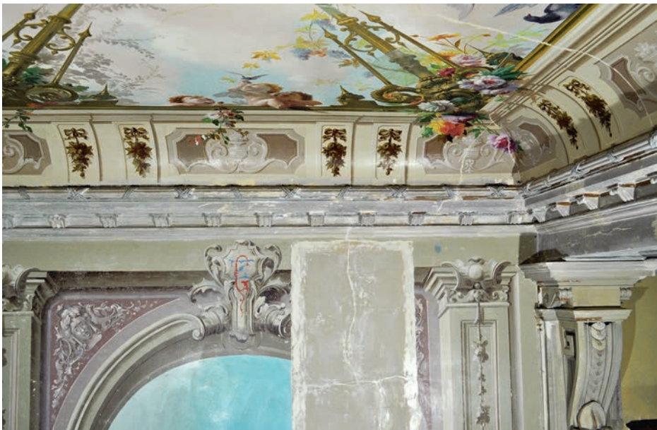
Die vertikal verlaufende Putzausbesserung an der Südostwand des Wintergartens. Laut Bauplan befand sich dahinter ursprünglich wohl ein Kaminzug. Zustand Juni 2012. Aufnahme ARGE F3M.
