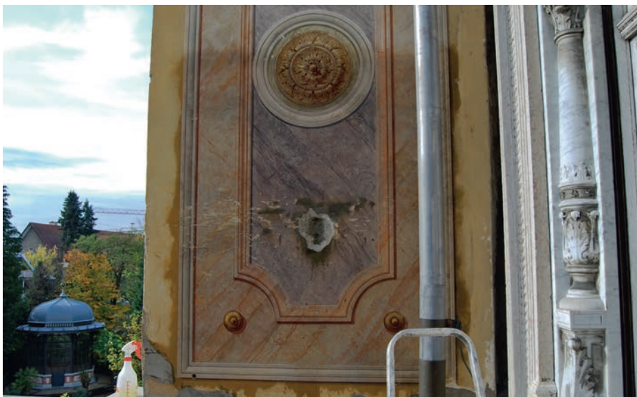
Oben: Prüfung der Festigkeit des Malgrunds in einer bestehenden Fehlstelle. Mitte: Anschliff des Materialaufbaus der Musterfläche nach erfolgter Festigung. Links: Musterfläche an der Südfassade. Umsetzung des Festigungsverfahrens von August bis Oktober 2008. BWS-Labor Winterthur.
