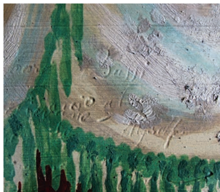
Links: Die Draperiemalerei in der Hohlkehle ist im Bereich über der südöstlichen Türblende nicht vollendet worden (rechte Bildhälfte). Zustand Juli 2011. Rechts: Nicht entzifferbare, eingeritzte Signaturen der Stuckateure im Streiflicht. Zustand Oktober 2011. IGA Archäologie Konservierung.
