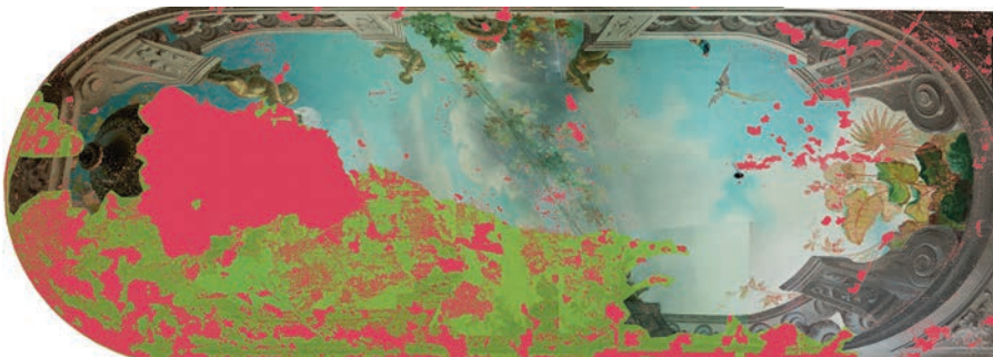
Kartierung der Ausbrüche und der geschädigten Zone im Bereich des Wassereintruchs. Die Dichte der Ausbrüche nimmt ausserhalb des Wasserschadens stark ab. Innerhalb der grün kartierten Zone mussten der Putz und die Malschichten gefestigt werden. Die Freilegung auf den durchweichenden Untergründen war hier deutlich schwieriger und aufwändiger. Kartierung Februar 2013. Stöckli AG Stans.
