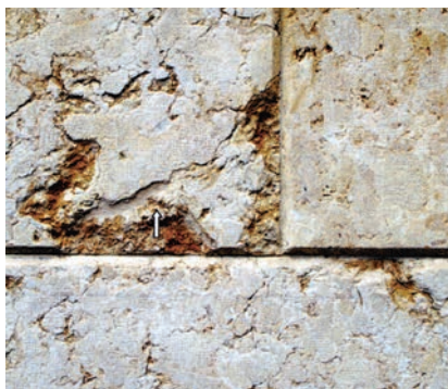
Anböschung an gelockerter Oberflächenpartie des gelben Solothurner Kalksteins am Erdgeschoss. Aufnahme November 2011. Frehner 2013 (wie Anm. 1), S. 36.
