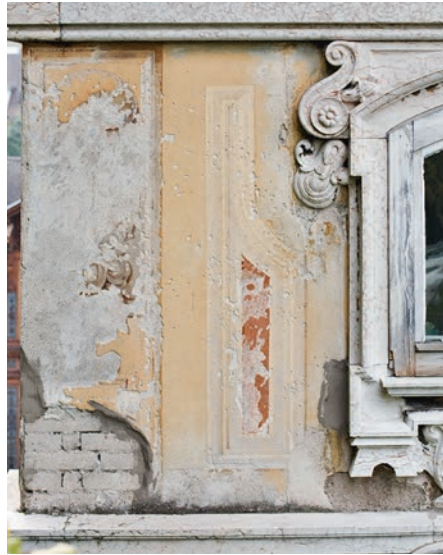
Links: Das bemalte Feld an der Westfassade ist der Witterung besonders ausgesetzt. Zustand vor der Restaurierung, April 2011. KDP Fotoarchiv. Rechts: Ausschnitt der Nordfassade mit partiellem Verlust des Malgrundes von 1885. Im unteren Bereich sind Randsicherungen einer jüngeren Phase erkennbar. Zustand vor der Restaurierung, April 2011. ARGE Konservierung/Restaurierung Fassaden Villa Patumbah 2013 (wie Anm. 28), S. 99.
