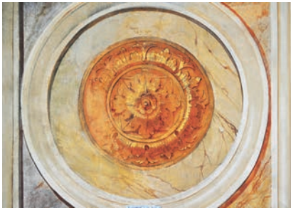
Rosette an der Nordwestfassade. Zustand November 2012. ARGE Konservierung/Restaurierung Fassaden Villa Patumbah 2013, S. 89.
