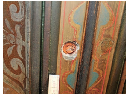
Oben: Offengelegte Schraube mit Mennige als Rostschutzanstrich sowie retuschierte Kittung am rechten Rand. Zustand Februar 2011. Aufnahme SUPSI.
