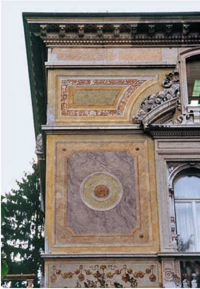
Die Musterachse an der Südostfassade. Die gereinigte Partie der Dachunter-sicht hebt sich deutlich von der unge-reinigten ab. Zustand Oktober 1998. KDP Fotoarchiv.
