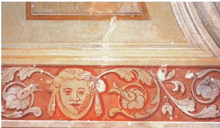
Oben: Die farbintensive Übermalung an der Südfassade geht über die Fläche der abgewitterten Risskittung von 1893 hinaus. Sie hat sich farblich verändert. Aufnahme April 2011. Links: Die Risse an der Südfassade hatten sich vermutlich bei einer ersten Bausenkung gebildet. Die Risskittung von 1893 wurde grosszügig übermalt. Diese Übermalung scheint heute vergilbt. Aufnahme Juli 2011. ARGE Konservierung/Restaurierung Fassaden Villa Patumbah 2013 (wie Anm. 28), S. 72 und 74.
