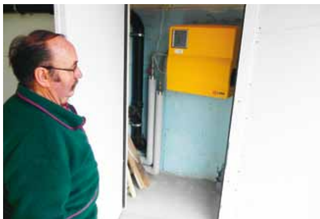
Walter Keller vor der relativ kleinen Pumpe seiner Regenwasserrückgewinnungsanlage.
