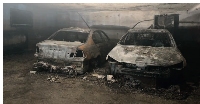
Der durch einen Fahrzeugbrand angerichtete Schaden ist beträchtlich
