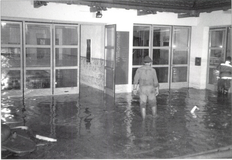
14.6.1999: Garage Karlen, Eggstrasse. An der Wand ist der Wasserhöchststand deutlich abzulesen.
