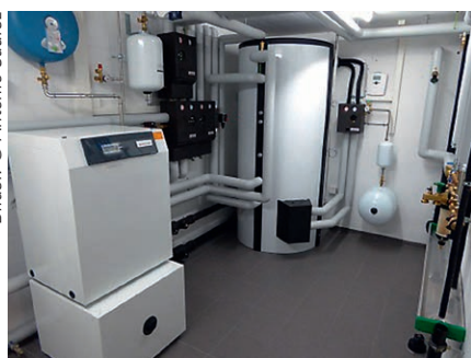
Kombispeicheranlage von Weishaupt mit Sole-Wasser-Wärmepumpe (links) und Energiespeicher (rechts) in Neubau der Familie Nauer, Oberwil-Lieli, AG
