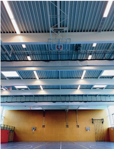
Bestehende Beleuchtungsanlage Sporthalle Andelfingen
