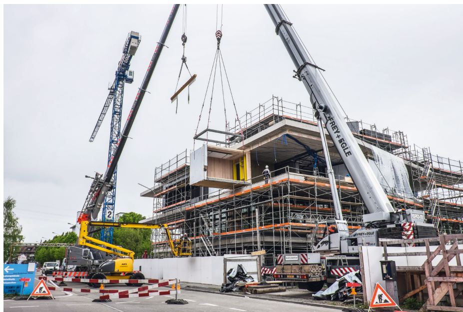
Der Einbau der Unit «Vision Wood» mit zwei grossen Kranen im April 2016.
