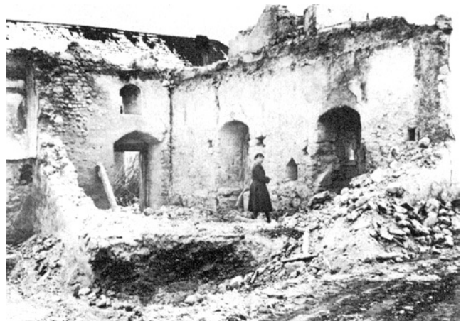
Embrach. Ehemalige Stiftskirche. Die noch erhaltene Westmauer und Südwestecke der Kirche während des Abbruchs des Bauernhauses J. Dünki, 1955
