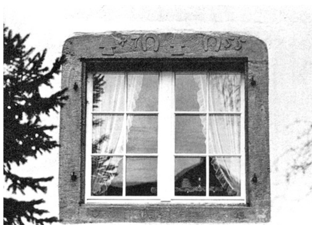
Hüttikon. Zürcherstrasse. Ehemaliges Bauernhaus Vers. Nr. 31 a. Fenster von 1755. Nach der Renovation 1977/78.
