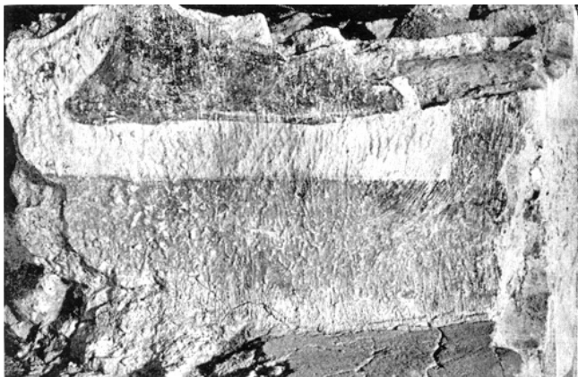
Herrliberg – Reformierte Kirche. Details der Wandmalereien von Chorbogen (unten) und Ostwand des Schiffes (oben). Die Malerei am Chorbogen war bei Anlage des polygonalen spätgotischen Chores und anlässlich des damit im Zusammenhang stehenden Umbaus des Chorbogens selbst zugemauert worden.
