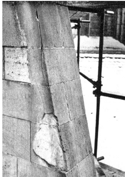
Fraumünster. Links Fensterscheitel und Bogenfries an der Ostwand des Chores, rechts Strebepfeiler an der Nordwestecke des Querhauses, Zustand vor der Restaurierung.
