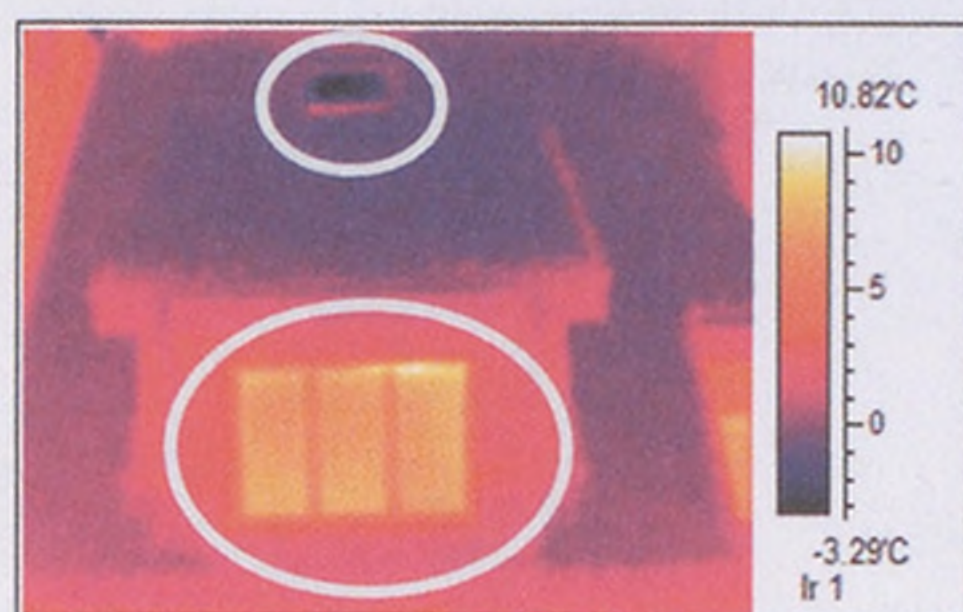
Gutes Dachfenster, schlechte Lukarne Temperaturumfang Aussenhülle: 14°C
