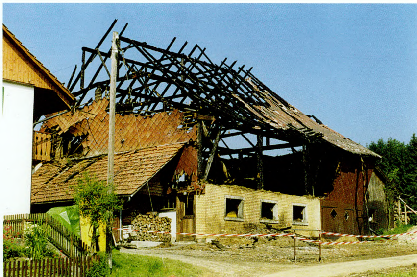
Infolge Blitzschlag völlig zerstört: die Scheune der Familie Schatzmann im Juni 1988.
