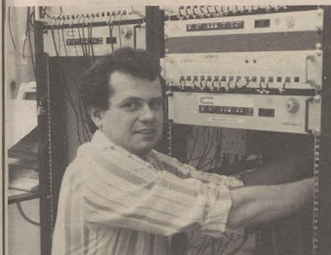
Heinrich Furrer installiert am Modem-Rack.
