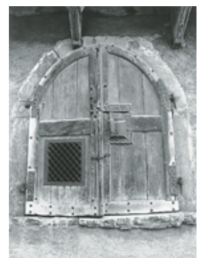
Giebelseitiges Sandsteinportal mit zweiflügeligem Bretttertor und dekorativem Riegelschloss. Zustand vor der Restaurierung, Juni 1995. Fotoarchiv HBA.
