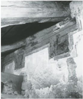
Ausschnitt des später verkleideten Fassadenabschlusses auf der Nordseite mit rot gefassten Balkenköpfen und grauen Begleitlinien in verschiedenen Fassungen (17. Jahrhundert). Zustand während der Renovationsarbeiten, März 1987. Fotoarchiv HBA.
