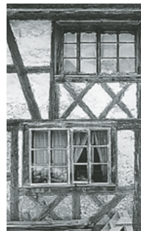
Teilansicht der nördlichen Giebelfassade des Hausteils Vers. Nr. 1420 vor der Renovation. Zustand Februar 1992. Fotoarchiv HBA.
