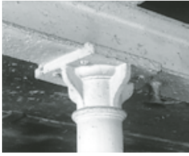
Fabrikationsgebäude Vers. Nr. 739 (vorher Nr. 738). Kapitell einer Gusseisensäule des Deckentragwerks. Zustand Juni 1999. Fotoarchiv HBA.
