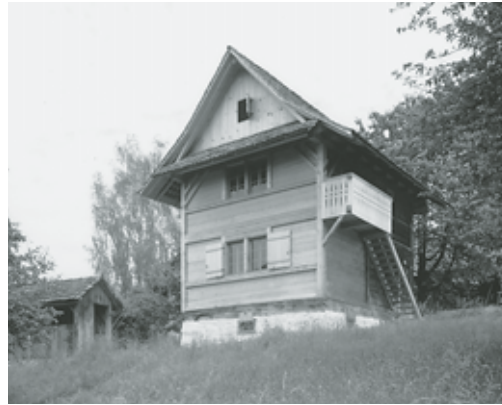
Links: Gesamtansicht der Südfassade, nachdem im Mai 1994 sämtliche Bohlen ausgebrochen sind. Zustand Juni 1994.
