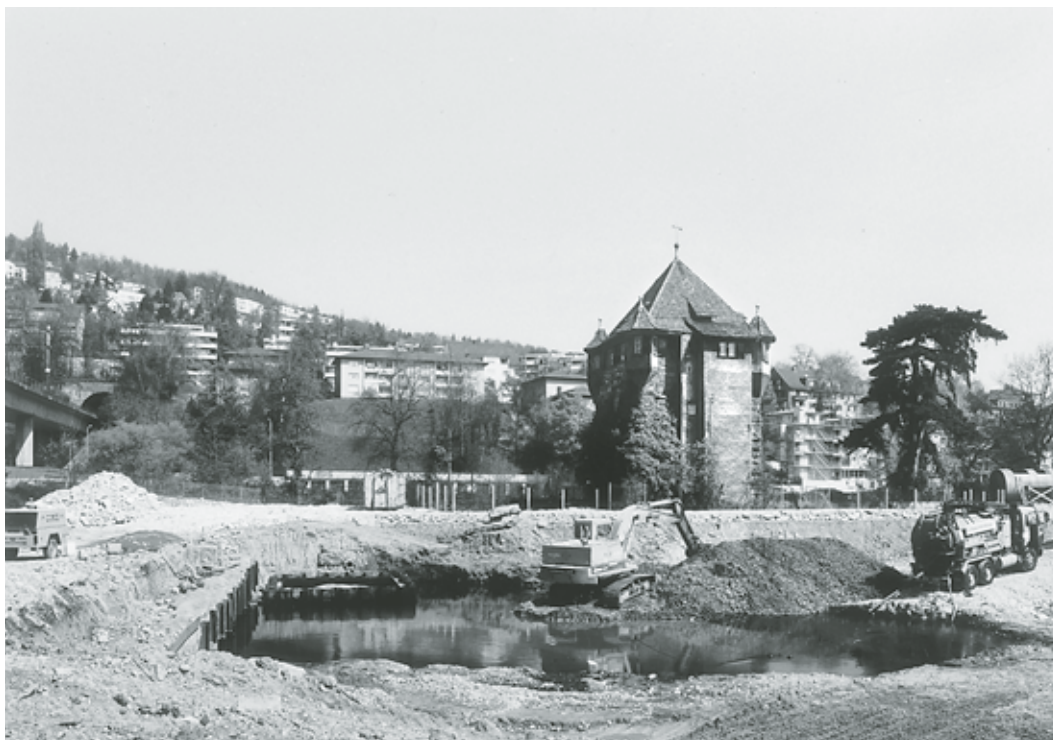
Der Wohnturm von Südwesten vor der Restaurierung. Zustand nach dem Abbruch der Fabrikbauten auf dem Schoeller-Areal, April 1997. Fotoarchiv HBA.
