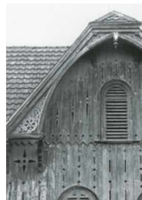
Teilsicht der Südwestfassade des ehemaligen Ökonomiegebäudes. Das Äussere kennzeichnen Rundbogenfenster mit Jalousieläden, eine dekorative Brettschalung der Holzständerkonstruktion sowie Rinde-Verkleidungen der Giebel im Schweizer Holzstil. Zustand vor der Renovation, Februar 1982. Fotoarchiv HBA.
