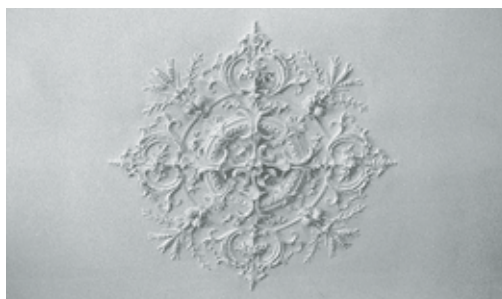
Teilansichten von zwei Stuckdecken im Obergeschoss. Links: Umfassender Fries mit Mittelornament. Rechts: Mittelmedaillon. Zustand vor der Renovation, August 1999. Fotoarchiv HBA.
