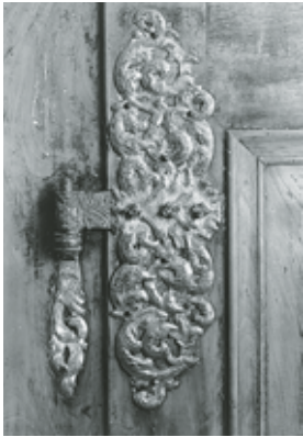
Reich verziertes Türband und Stützhaken an einer Türe der östlichen Wohnstube im Hochparterre. Zustand vor der Renovation, Februar 1999. Fotoarchiv HBA.
