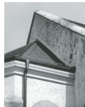
Teilansicht des westlichen Langhausgiebels mit Bauschäden. Zustand vor der Aussenrenovation, April 1990. Fotoarchiv HBA.
