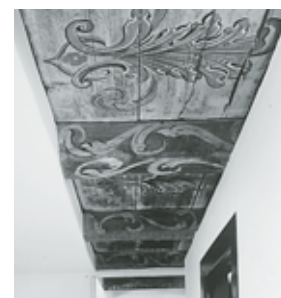
Restaurierte, mit Ranken in Grisaille bemalte Balkendecke im Korridor des 1. Obergeschosses (Raum Nr. 1.01). Zustand Oktober 1998. Fotoarchiv HBA.
