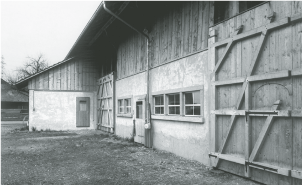
Stallscheune Vers. Nr. 770. Teilansicht der westlichen Trauffassade mit dem neu angebauten Milchzimmer unter Pultdach und den beiden neuen Toren. Zustand April 1998. Fotoarchiv HBA.
