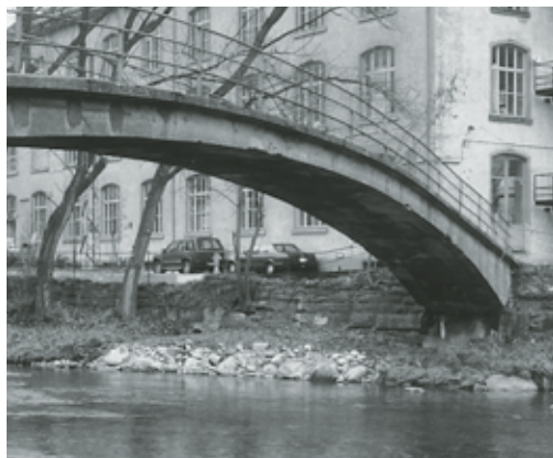
Links: Brückenuntersicht bei Beginn der Instandstellungsarbeiten 1999. Rechts: Ansicht des Brückenbogens mit deutlich erkennbaren Betonschäden. Zustand 1995. Fotoarchiv HBA.
