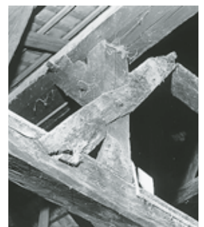
Detail des stehenden Dachstuhls mit ursprünglich schwach geneigtem Satteldach. Zustand 1972. Fotoarchiv HBA.
