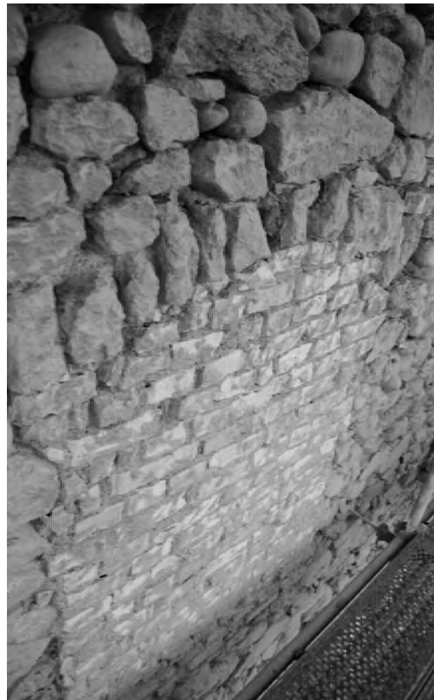
Irgend jemand hat da vor Jahrzehnten ein Fenster in der Bruchsteinmauer einfach mit Backsteinen zugemauert.
