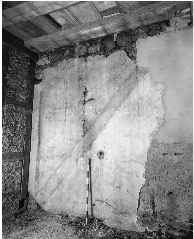
Abb. 30. Winterthur. Marktgasse 44. 3. Obergeschoss: westliche Brandmauer mit Spuren eines Treppenlaufs, einer Binnenwand und einer Deckenhöhe der Zeit vor 1815, Pos 675.
