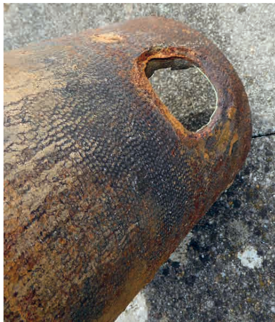
Kaputte Wasserleitung aus der Heiligbergstrasse
