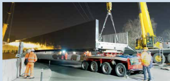
Mitten in der Nacht wird in Effretikon die Stahlbrücke über die Gleise gelegt.
