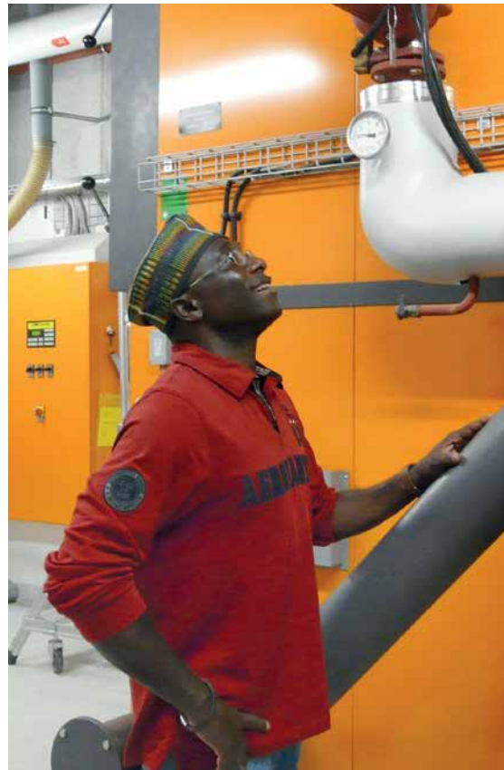
Der Abwart an der Arbeit im Heizungskeller des Schulhauses Hagen.
