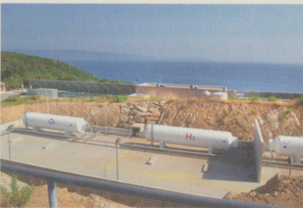
«Power to Gas»-Anlage des französischen Energieforschungszentrums auf Korsika. Bild: zVg
