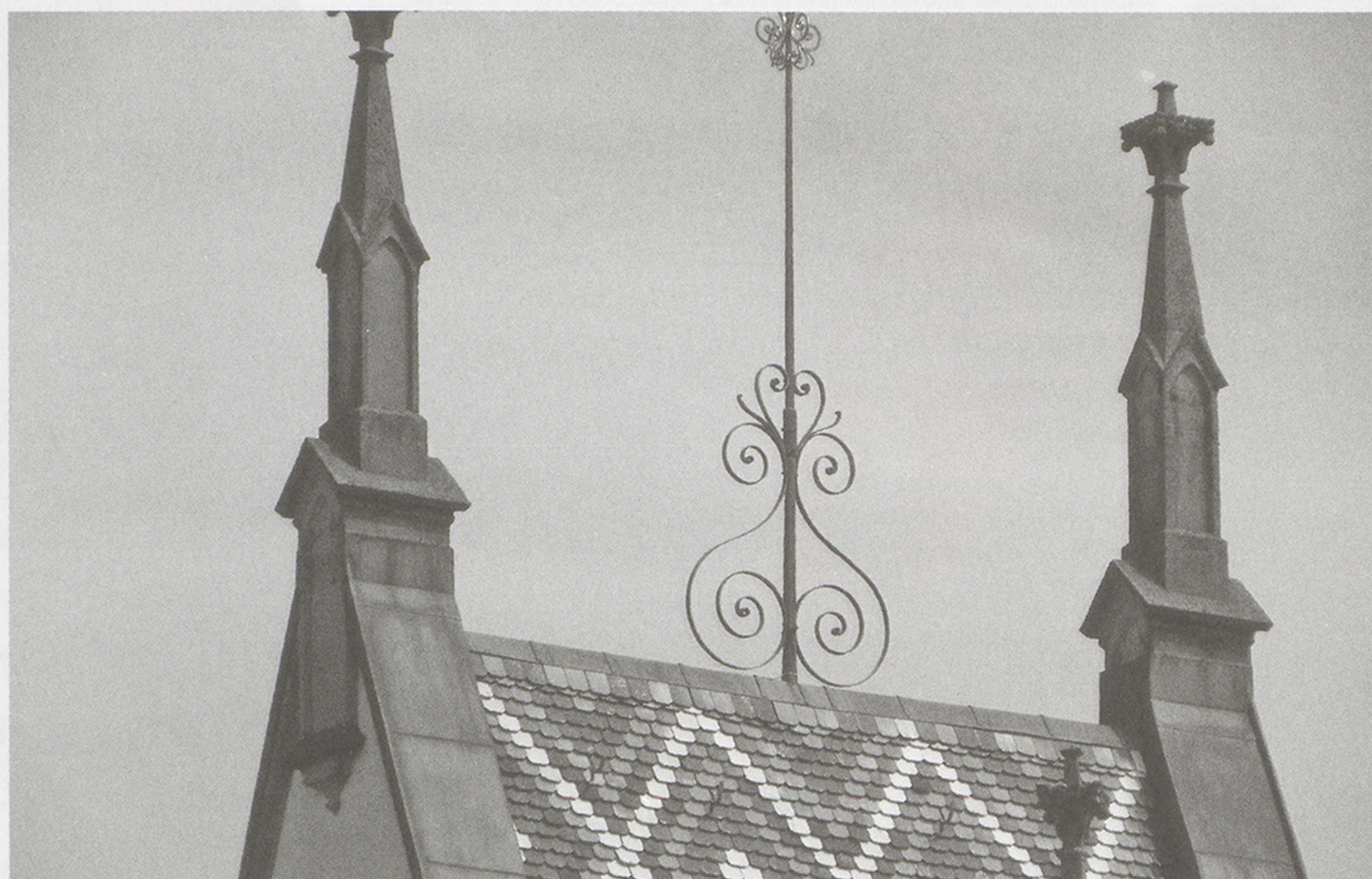
Hübsch schauen sie doch aus, die Türmchen auf dem Maurer Kirchenturm – ein Jammer, sie wären wegrenoviert worden! (Foto: cl)
