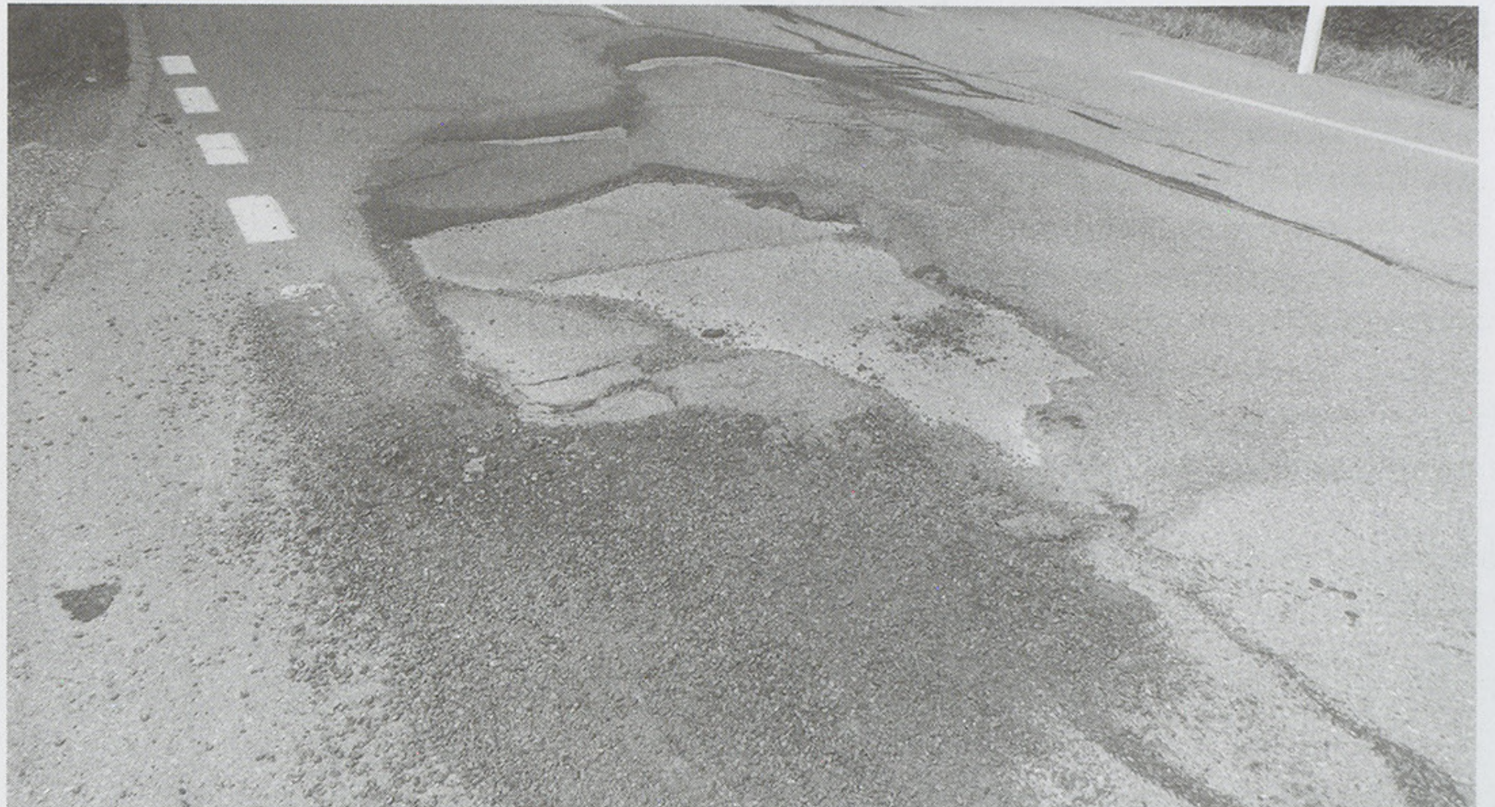
Arger Belagsschaden auf der Zürcherstrasse – lebensgefährlich für Zweiradfahrer dazu! (Foto: cl)
