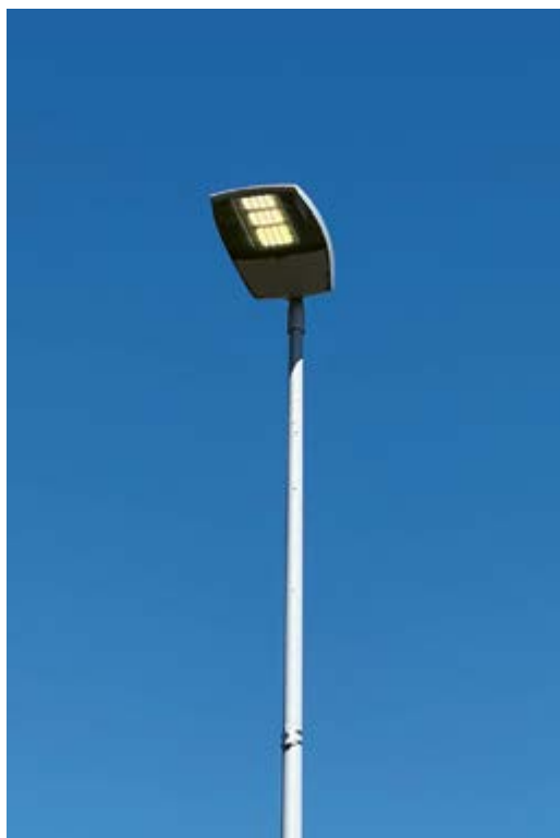
Erleuchtet den helllichten Tag: Strassenlaterne in Ebmatingen. Bild: Evelyn Zwick
