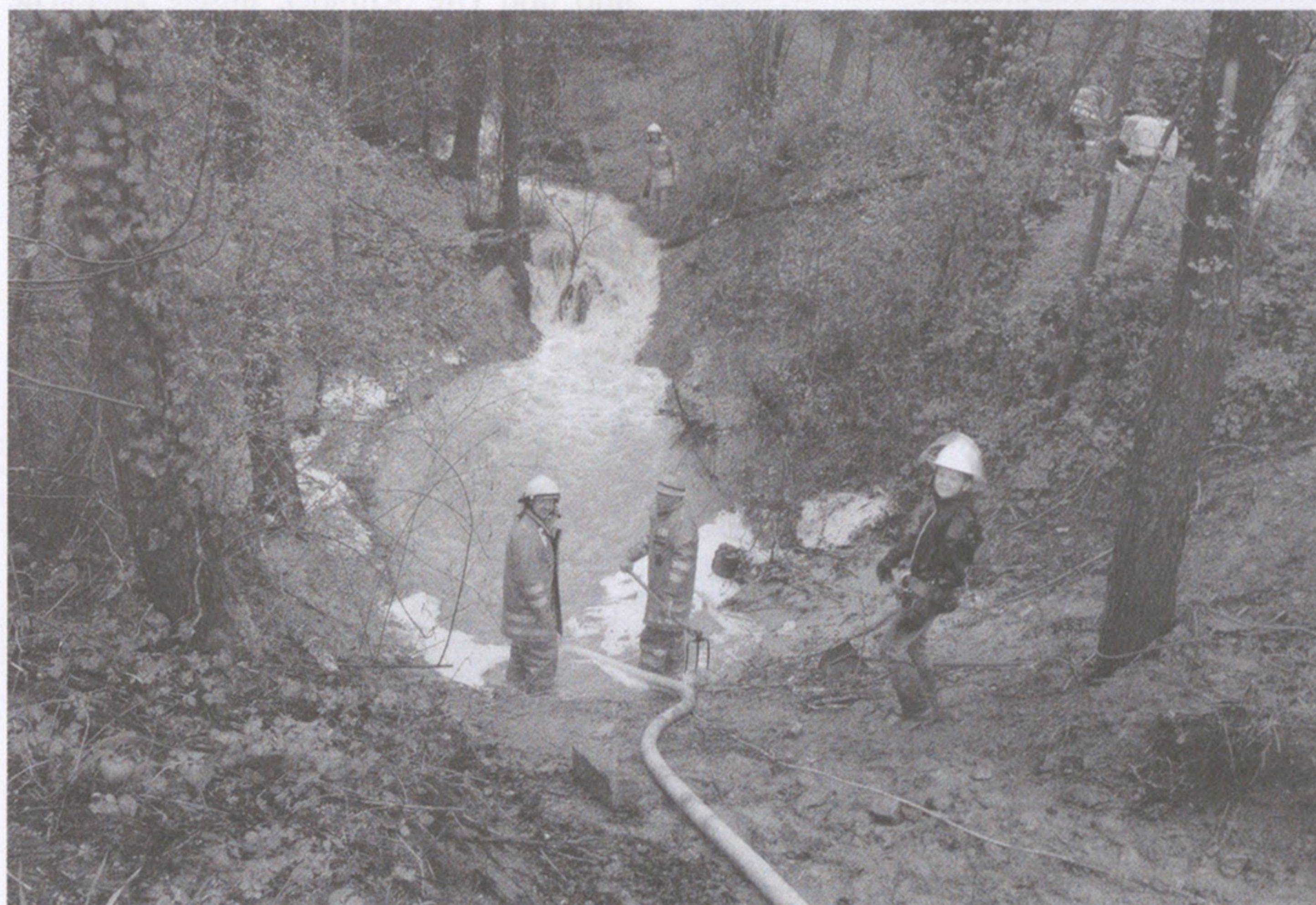
Die Regenfälle Anfang Woche erforderten einen Grosseinsatz der Feuerwehr Maur. Hier beim Bach «Im Regenbogen», wo das Wasser abgepumpt wurde, damit es keine Überschwemmung oder einen Erd-rutsch gibt – ebenso bei der Unterführung des Loorenschulhauses und an weiteren Orten. (Foto: sl)
