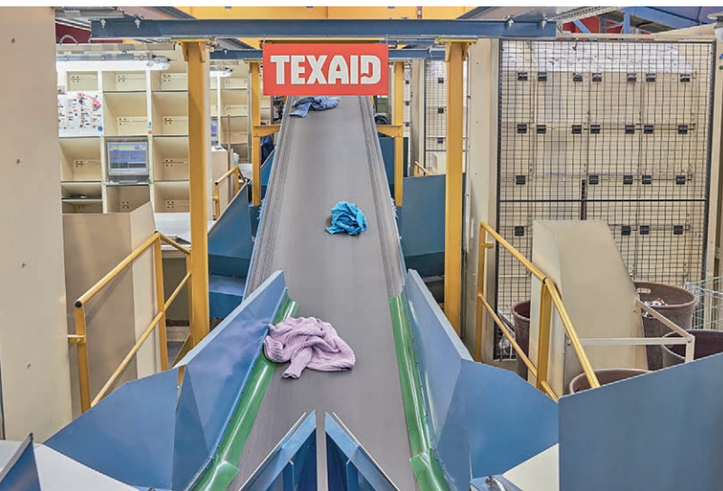
Sortieranlage in Schattdorf UR
