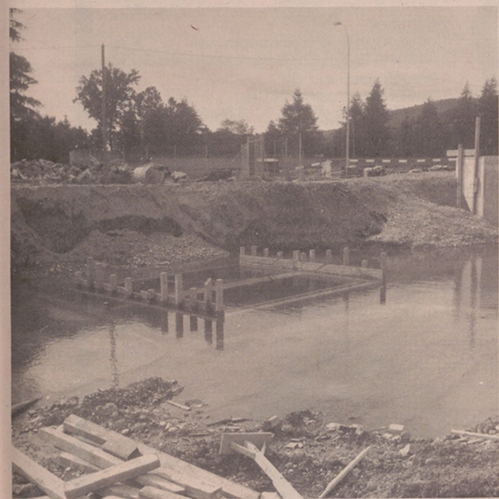
Die im Bau befindlichen Objekte schwimmen im Grundwasser (Fassungsstelle für Gebrauchswasser).
