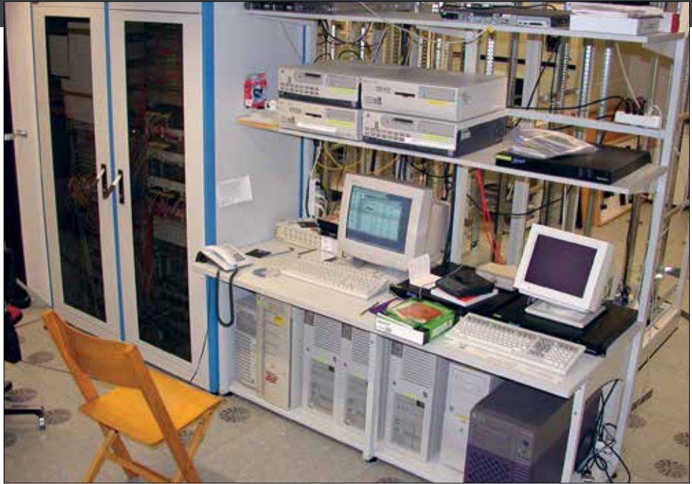
Serverraum vor der Erneuerung im Jahr 2004.
