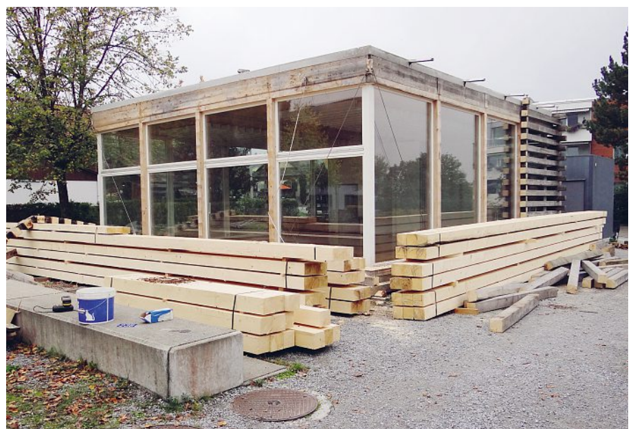
Das Lotharhaus in Binz erkennt man kaum wieder. Eine Renovation ist fällig. (Foto: Stephanie Kamm)
