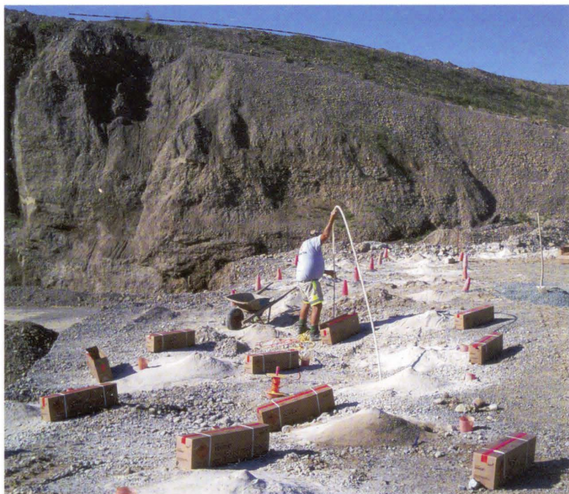
Die Löcher sind gebohrt, nun platziert Jakob Keller die Sprengladungen. (Bild: Christian Ilg)
