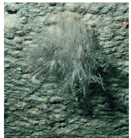
An den Wänden fanden sich Salzausblühungen in unterschiedlichen Erscheinungsformen. Das Foto zeigt einen nadeligen Flaum mit einzelnen langen «Whisker», der aus einer kleinen Fehlstelle in den Malschichten wuchs. Foto: Fabienne Oberli.
