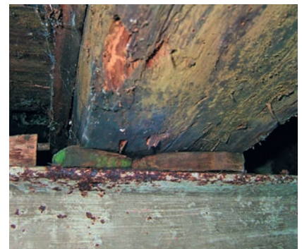
Oben: Der Vergleich von Proben aus gelbbraunen bzw. grauen Bereichen mit unverfärbten Stellen ergab, dass die verfärbten ausgeprägte Kalksinterkrusten aufwiesen. Unten: Die bauzeitliche Holzdecke wies Spuren des feuchten Raumklimas auf: Die Holzoberfläche zeigte braun-faule Stellen und Pilzkörper. Fotos: Fabienne Oberli.
