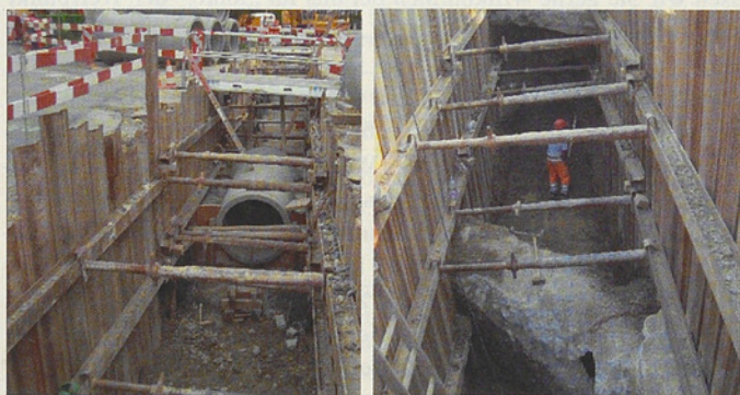
Neue Rohre für den Katzensteigbach Für den Dücker war ein tiefer Graben nötig
