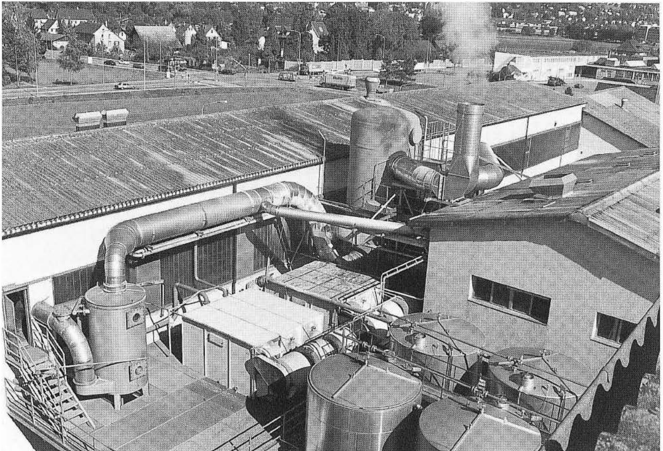
Abluftreinigungsanlage mit Ozon, Rückkühler der Warmwasserkreisläufe, Teilansicht Knochenfett-Lagertanks 1994
