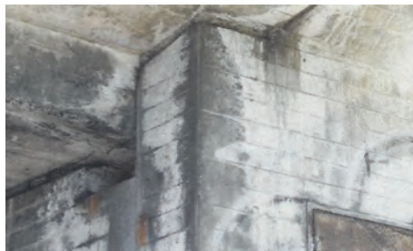
Starke Korrosionsschäden machten einen Totalabbruch nötig.
